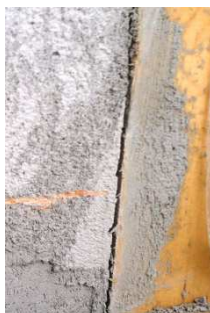
Crepe tra controtelaio e muro nella parte interna.
