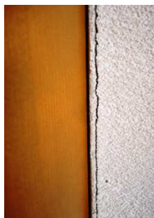
Crepe tra controtelaio e muro nella parte esterna.
