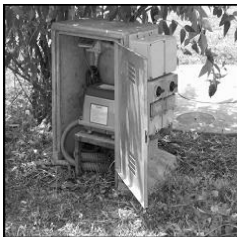
ESEMPIO DI LOCALE TECNICO
